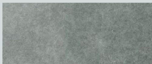
Imperfections ou finition fortement égalisée ou finition minérale dans une teinte assortie
