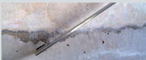
Béton neuf avec défauts à colmater
