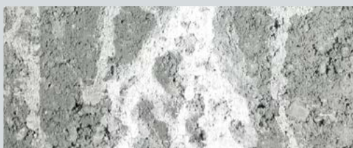
Béton neuf avec de grosses imperfections
